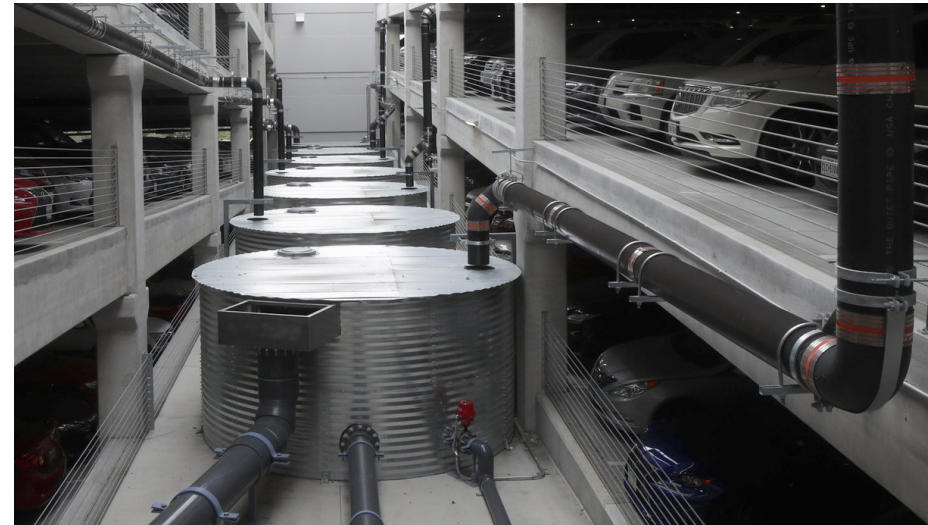
Citerne pour l'eau de pluie au siège social de Toyota Motor North America, Inc. à Plano, au Texas
